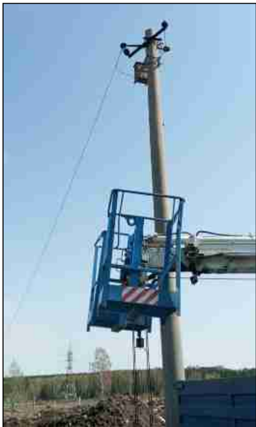
Опора № 1, с установленным на ней повышающим трансформатором ОМП-6/0,23кВ и находящимся рядом многофункциональным краном-манипулятором МКМ-200
